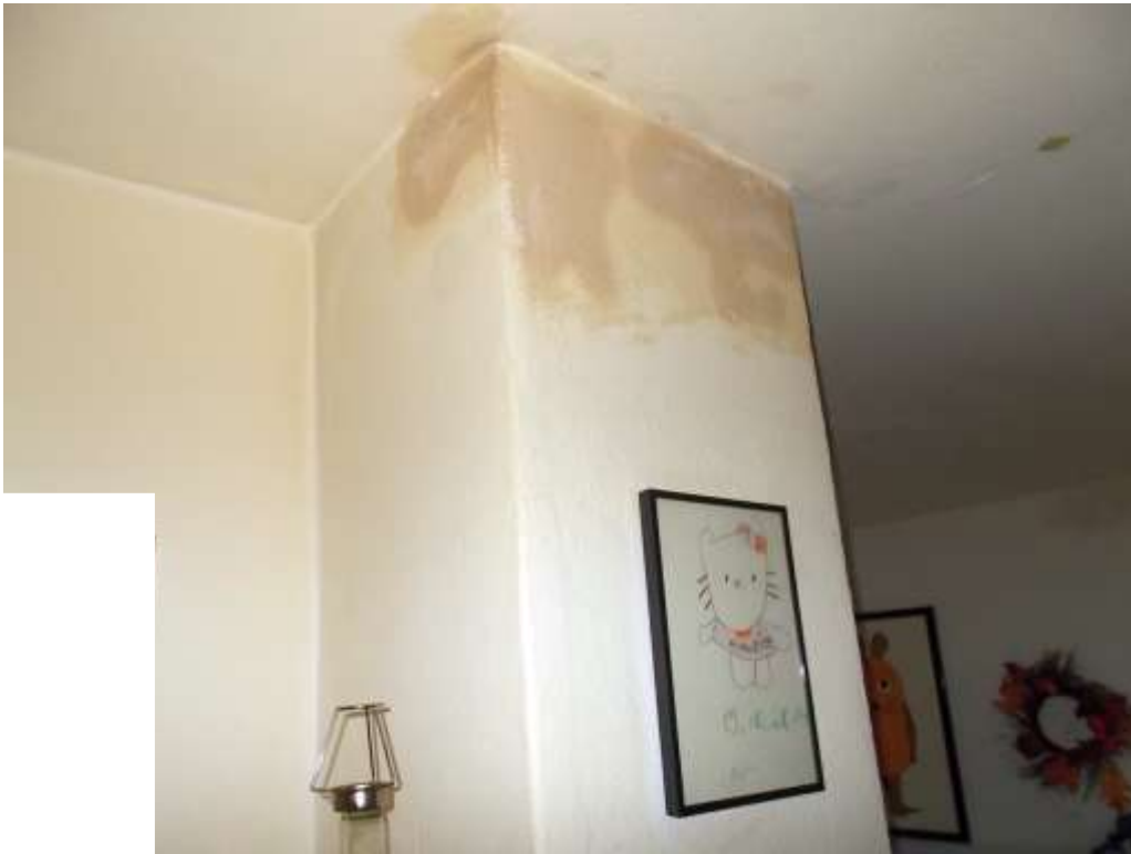
Whg. 2 DG: Flur – Feuchtigkeit am Schornstein
