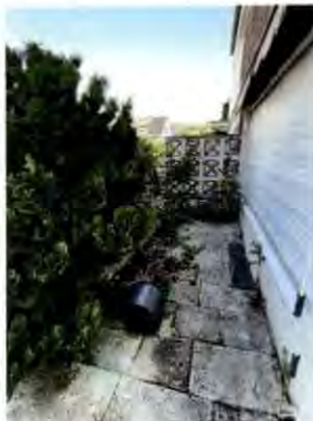
beispielhafte Ansicht der Südwest-Terrasse mit starken Unebenheiten
