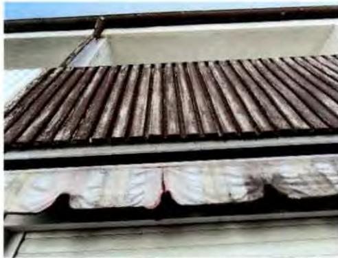
beispielhafte Ansicht der erneuerungsbedürftigen Regenrinne/Stehrinne (Südwestseite), der Farbabblätterungen im Bereich der Balkonbrüstung sowie der erneuerungsbedürftigen Markise
