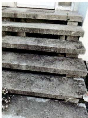
beispielhafte Ansicht der Beschädigung an der Außenseite der Treppenstufe
