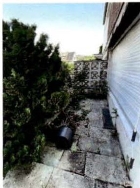
beispielhafte Ansicht der Südwest-Terrasse mit starken Unebenheiten
