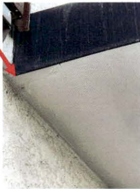
beispielhafte Ansicht der Farb- und Putzabplatzungen an der Unterseite der Eingangsüberdachung
