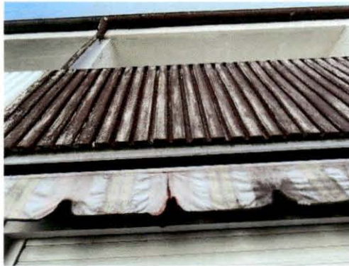
beispielhafte Ansicht der erneuerungsbedürftigen Regenrinne/Stehtinne (Südwestseite), der Farbabblätterungen im Bereich der Balkonbrüstung sowie der erneuerungsbedürftigen Markise
