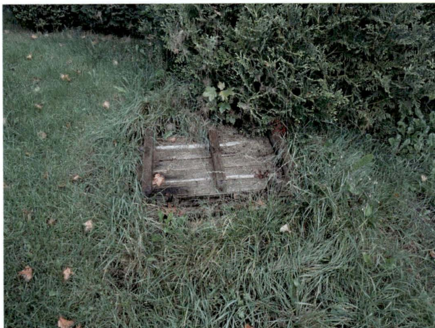
Bild 10: Deckel der Kleinkläranlage
