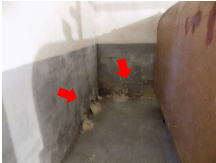
KG; Tankraum, Pfeile: Kapillarfeuchte mit Putzablösung
