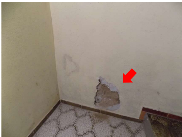
KG Treppenhaus, Pfeil: Kapillarfeuchte mit Putzablösung
