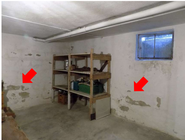
KG; Kellerraum der Whg. Nr. 2: Pfeile: Kapillarfeuchte mit Putzablösung
