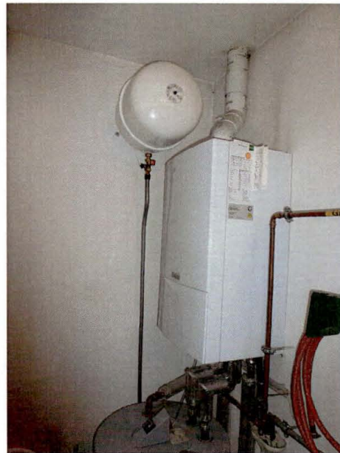
Blick auf die Heizungsanlage
