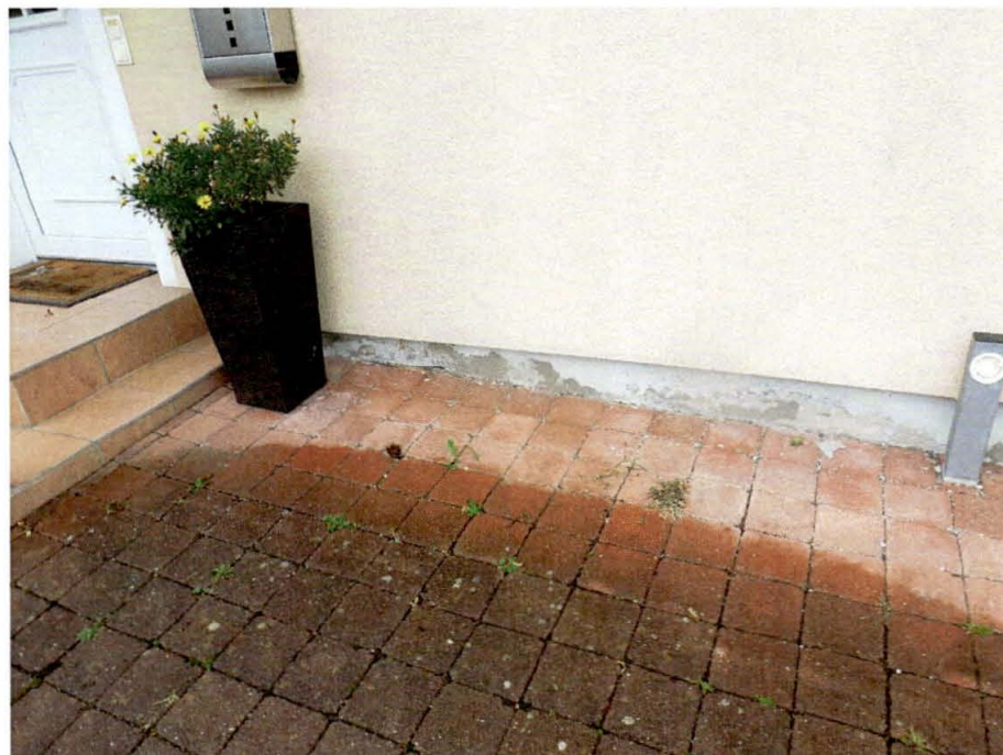
Farb- und Putzablösungen im Sockelbereich des Einfamilienhauses
